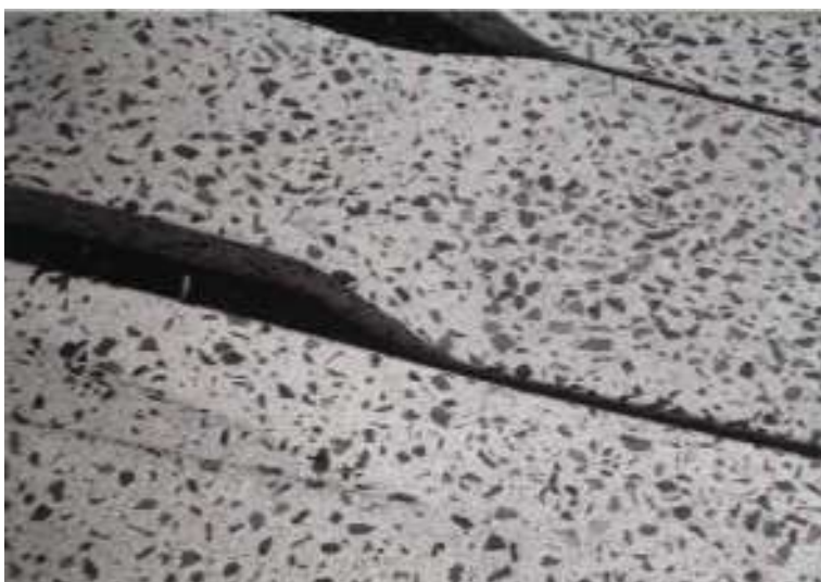
Figura 1- Fotografia de superfície de concreto com fissuras (POUCHAIN, 2015, n.p.)
